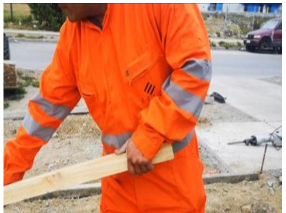
Se observa tablón retirado desde el camión, movimientos de flexión de codos, agarre con fuerza de ambas manos. Sin uso de guantes.
